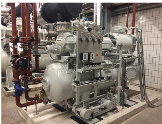
Een koelinstallatie voor (boven) en na (onder) een grondige revisie.
